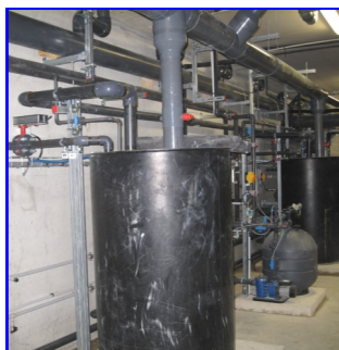
Bacs tampons de l'extension...
