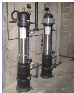
Système d'ultrafiltration en chaufferie...
